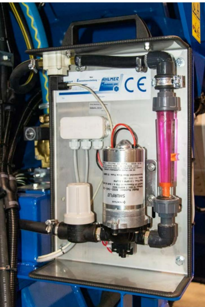
Pump med filter, inspektionsglas och elektronisk flödesmätare
